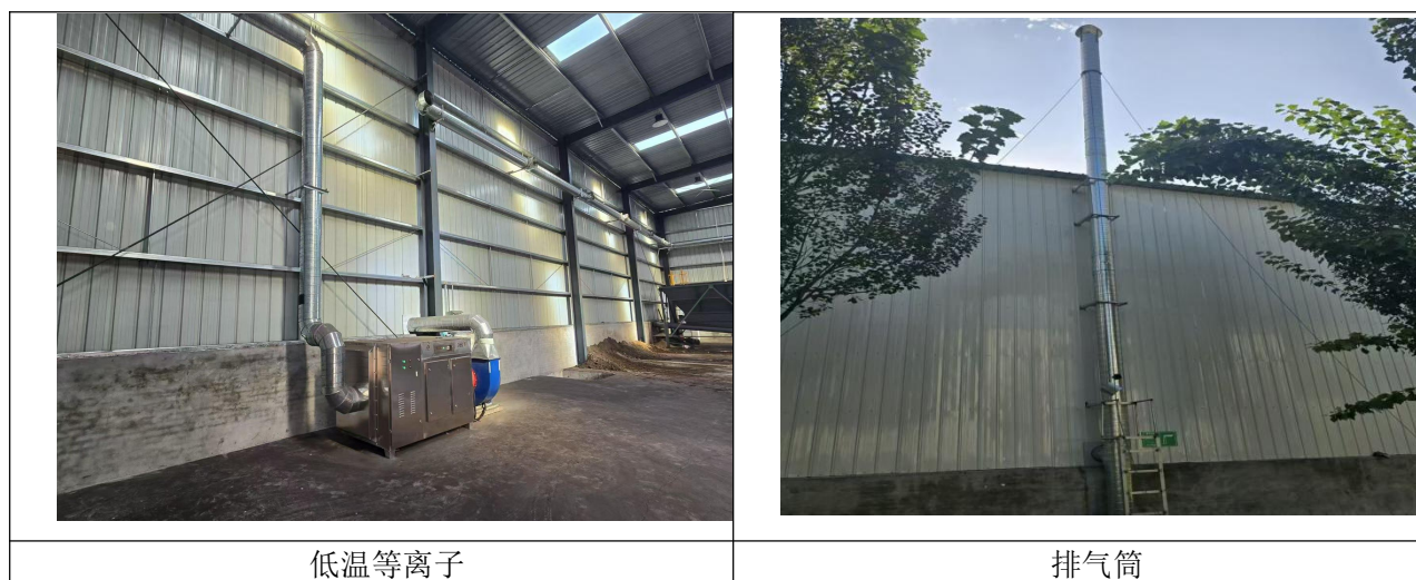
图 4.2-1 废气处理设施现场照片
