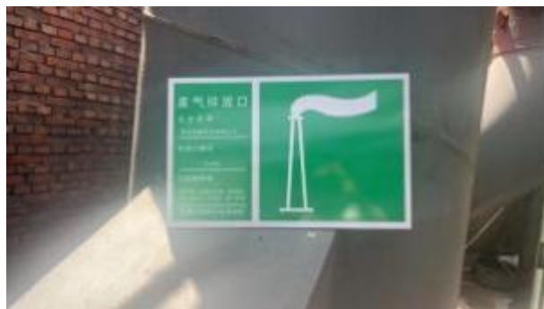
图 4.2-7 干污泥仓废气排放口
