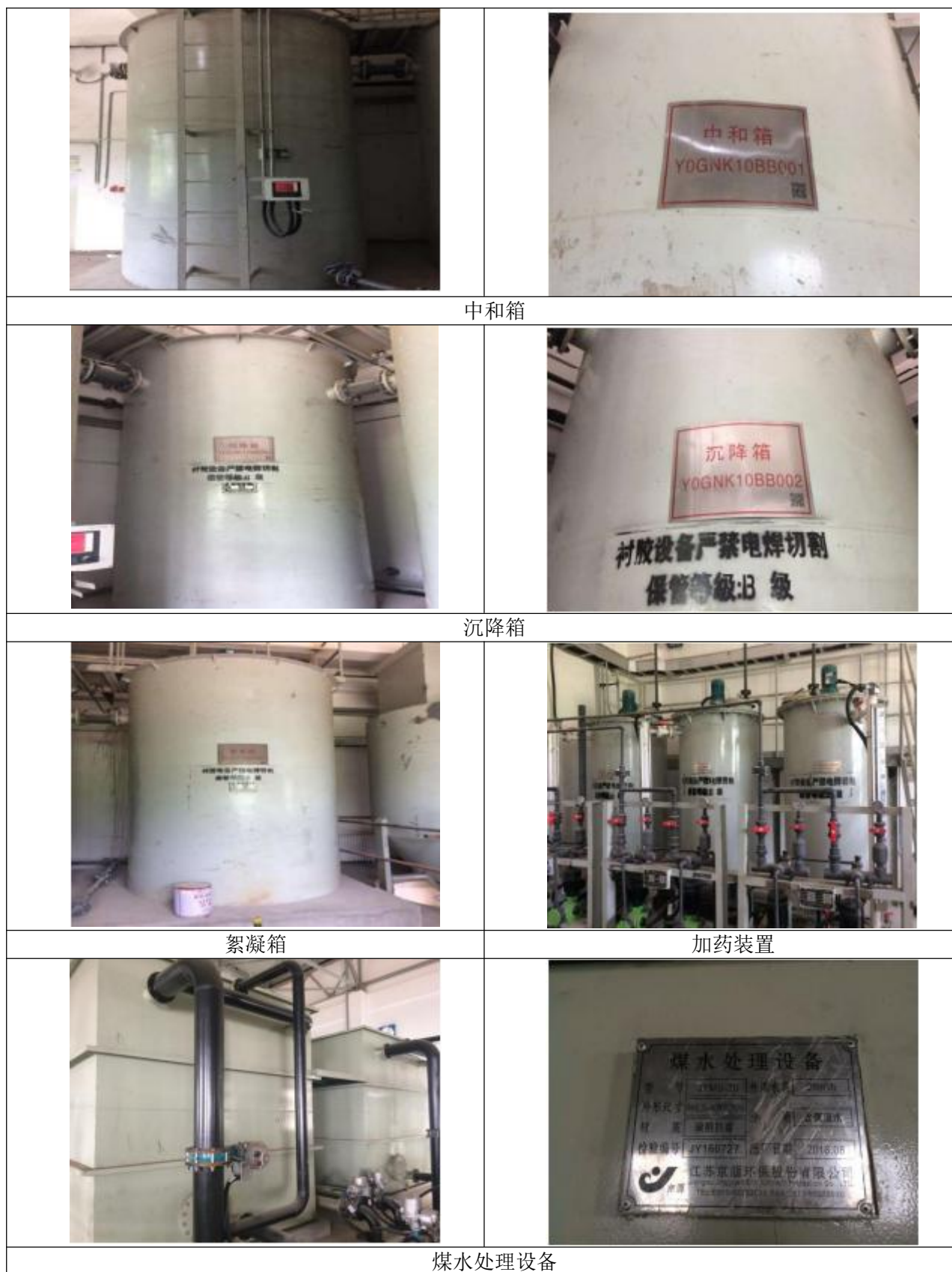
图 4.2-3 废水处理设施现场照片
